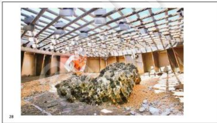
รูปที่ ๒๗-๒๘ ภาพถ่ายการปนเปื้อนเชื้อราในอาคารที่ดำเนินการบูรณะและรักษาอาคาร
